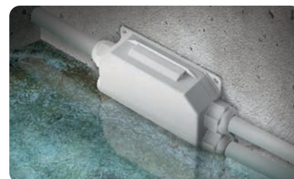
Instalação com prensa cabo.
